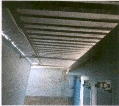
Foto 1: Sustitución de lámina, por lamina troquelada aluzinc calibre 26. en corredor de baños.
